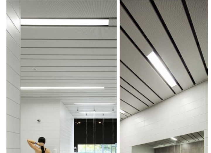
P4 Aluminium systeemplafond bij de douches
