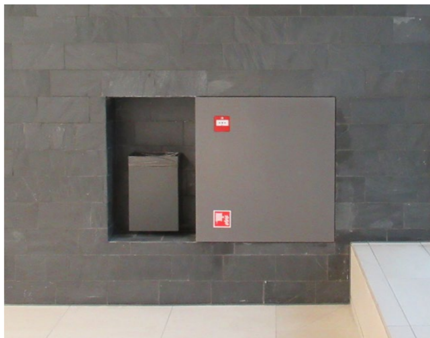
A10 In de wand geïntegreerde afvalbakken en brandslanghaspels
